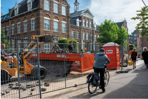
In verband met de nieuwe bestemmingen van het Kloosterkwartier zijn nieuwe aansluitingen op het riool nodig. Het leidde tot het openbreken en opnieuw bestraten van de Deken van Miertstraat.
